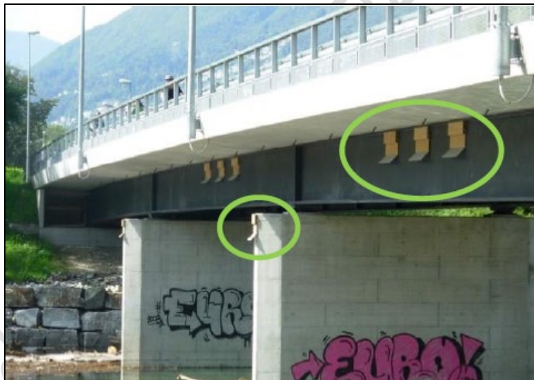
Abbildung 129 Beispiel eines eingebauten Fledermausquartier an oberirdischer Querung
